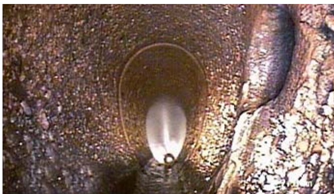
Kanał betonowy przed renowacją, widoczna korozja, przykanalik z prawej
