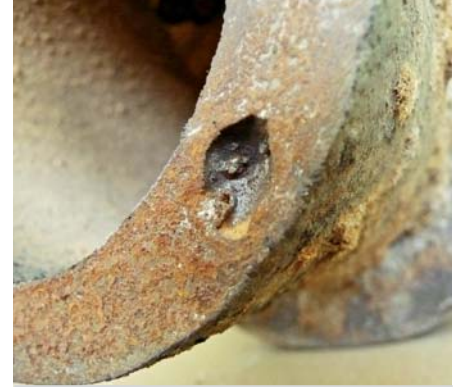
Ryc. 6. Pustki powietrzne w ścianie przeciętej rury z żeliwa szarego, fot. A. Kuliczkowski
