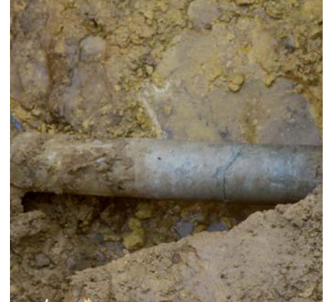
Ryc. 9. Rurociąg azbestowo-cementowy DN 100 z obwodowym pęknięciem, fot. A. Kuliczkowski
