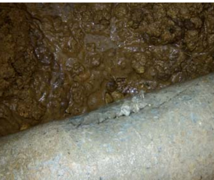
Ryc. 10. Wgniecenie ścianki rury azbestowo-cementowej przez duży kamień o ostrych krawędziach, fot. A. Kuliczkowski
