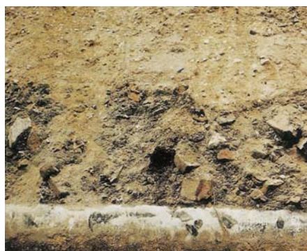
Ryc. 1. Rurociąg stalowy \varnothing 200 mm z uszkodzeniami izolacji i powłoki rurowej spowodowanymi zasypką kamienistą wykopu
