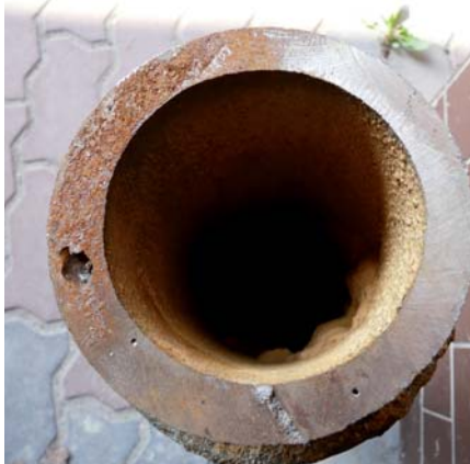
Ryc. 8. Rurociąg żeliwny Ø 80 mm o zmiennej grubości ścian od 12,3 do 14,2 mm, fot. A. Kuliczkowski
