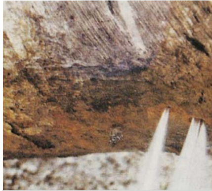
Ryc. 5. Rurociąg stalowy Ø 500 mm z perforacją dna i widocznymi intensywnymi wytryskami wody [11]
