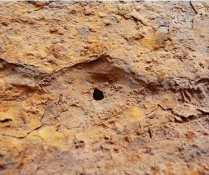
Ryc. 7. Nieckowata (w formie „plam”) korozja wewnętrznej powłoki rury stalowej DN 800 z jednym wżerem „na wylot” i niezabezpieczonej od wewnątrz przed korozją, fot. A. Kuliczkowski
