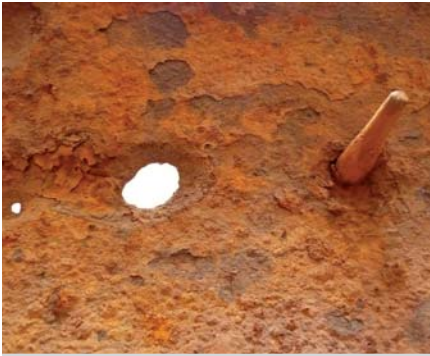
Ryc. 4. Trzy wżery korozyjne „na wylot” w rurze stalowej DN 800 z jednym uszczelnionym od zewnątrz za pomocą drewnianego kołka, fot. A. Kuliczkowski
