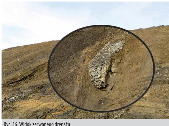
Ryc. 16. Widok zerwanego drenażu
