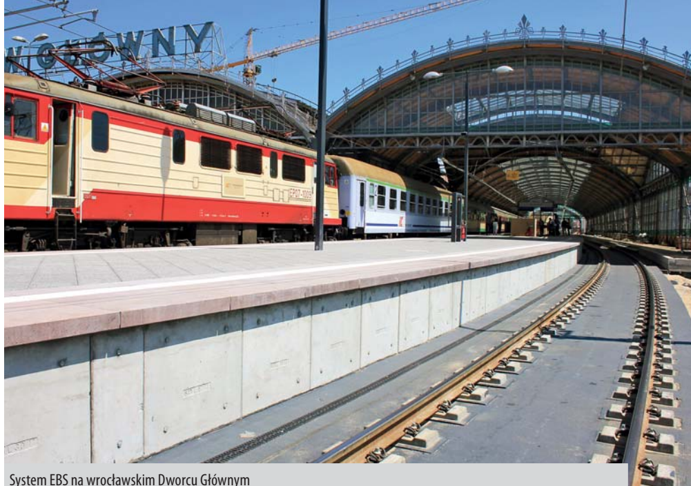
System EBS na wrocławskim Dworcu Głównym
