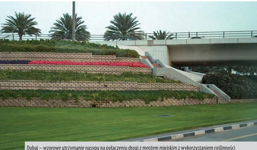
Dubaj – wzorowe utrzymanie nasypu na połączeniu drogi z mostem miejskim z wykorzystaniem roślinności
