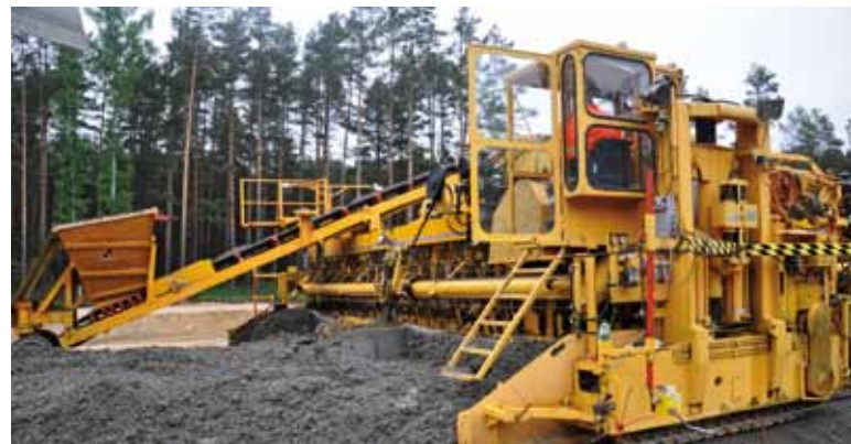
Układarka do betonu w trakcie wbudowywania dolnej warstwy betonu (nawierzchnia betonowa składa się z dwóch warstw dolnej oraz górnej, wykonywanej w technologii na mokro)
