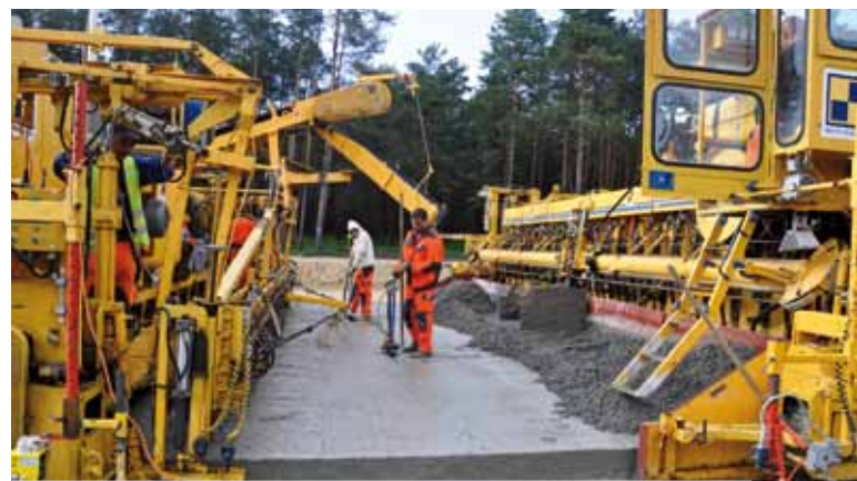
Z lewej: układarka wbudowująca beton w dolną warstwę nawierzchni, z prawej: układarka służąca do wbudowania górnej warstwy betonu
