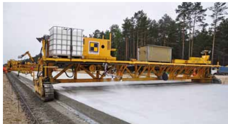
Urządzenie pokrywa powierzchnię świeżego betonu opóźniaczem wiązania oraz zabezpiecza beton przed nadmiernym odparowaniem wody
