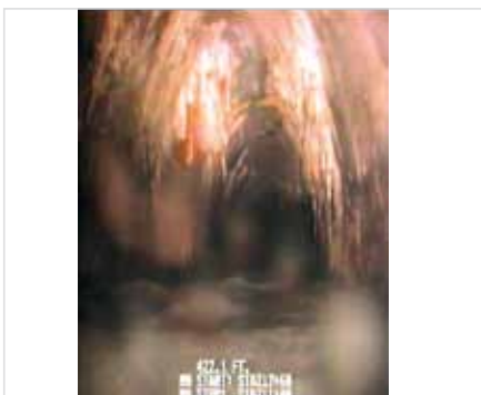
Ryc. 1. Uszkodzony kolektor o wymiarach 2134/2134 mm
