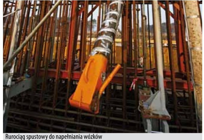
Rurociąg spustowy do napełniania wózków
