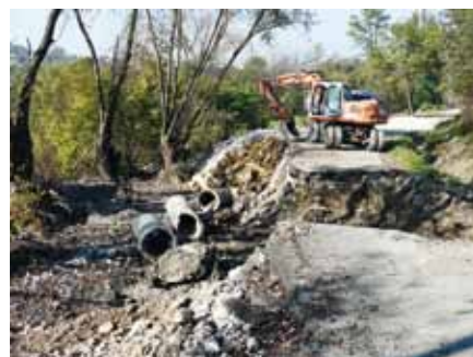
Ryc. 11. Zniszczona droga w Ochojnie, fot. R. Kaczmarczyk
