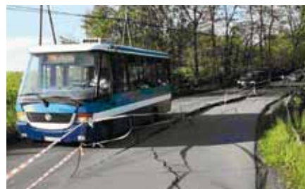
Ryc. 12. Zniszczona droga w Świątnikach Górnych, fot. R. Kaczmarczyk
