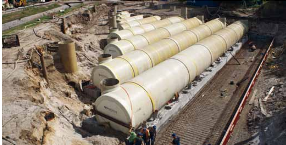
Zbiornik retencyjny DN 3000 w al. Wilanowskiej w Warszawie
