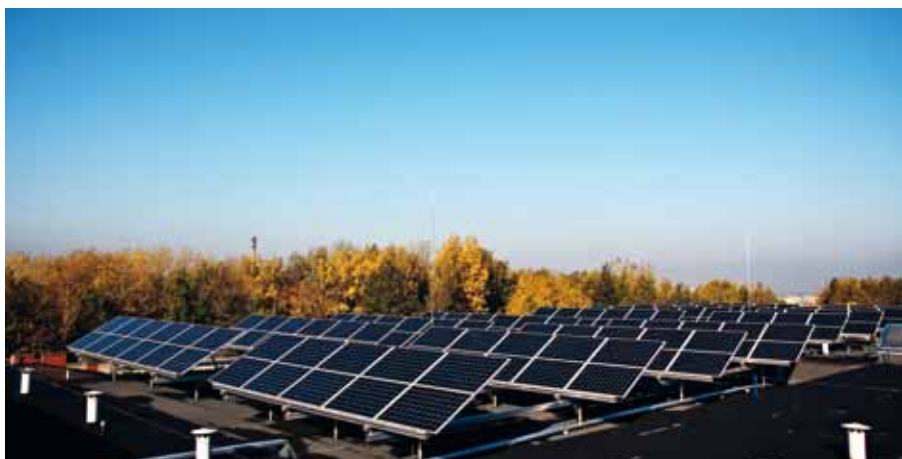
Instalacja fotowoltaiczna na dachu zbiorników wody Górnośląskiego Przedsiębiorstwa Wodociągów SA w Rudzie Śląskiej-Czarnym Lesie
