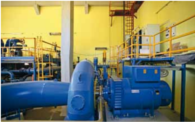
Ryc. 1. Turbina Francisca w komorze regulacyjnej KP 3
