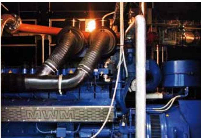
Ryc. 6. Szesnastocylindrowy silnik układu kogeneracji w oczyszczalni Płaszów
