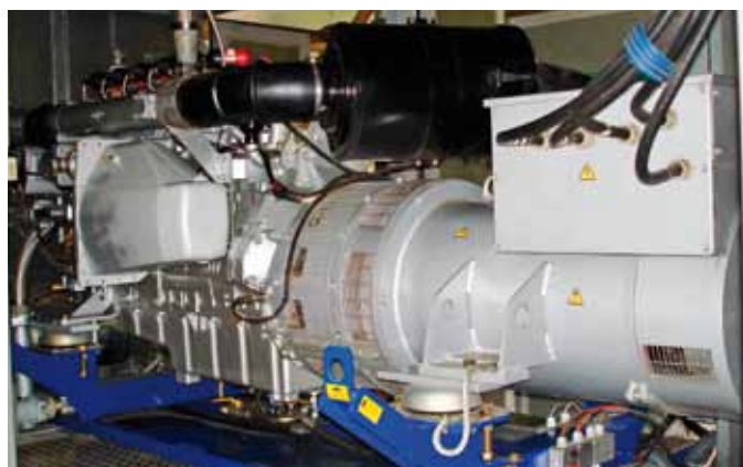
Ryc. 5. Jedna z trzech jednostek kogeneracyjnych z sześciocylindrowym silnikiem gazowym z zapłonem iskrowym pracująca w oczyszczalni ścieków Kujawy
