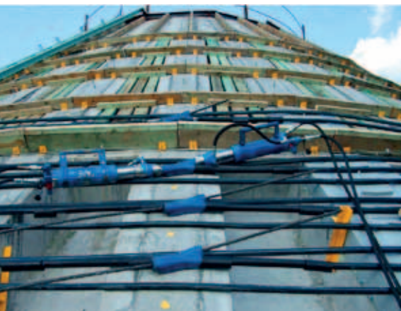
Ryc. 15. Przykład wzmocnienia konstrukcji żelbetowej systemem NSS
