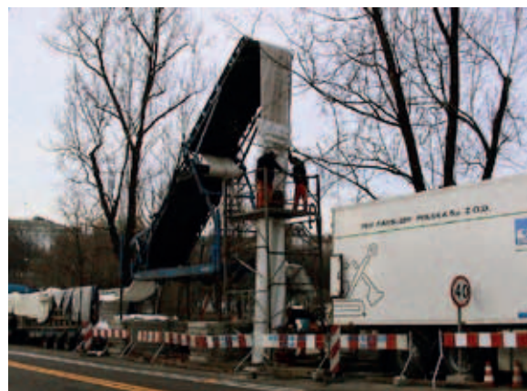
Ryc. 3. Specjalny przenośnik taśmowy wraz z wieżą inwersyjną [5]
