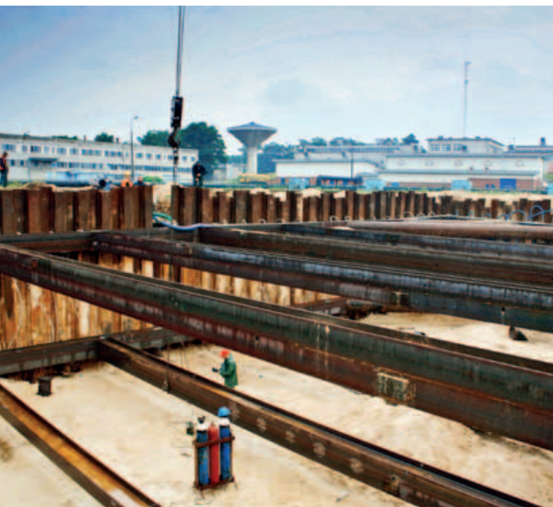
Zbiorniki wyrównawcze popłuczyn z filtrów
