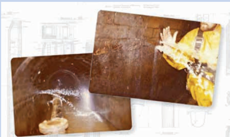
Ryc. 6. Zdjęcia tunelu wykonane podczas jego inspekcji. Widoczne są duże przecieki do jego wnętrza. W tle fragmenty projektu tunelu sprzed ponad 100 lat [2]
