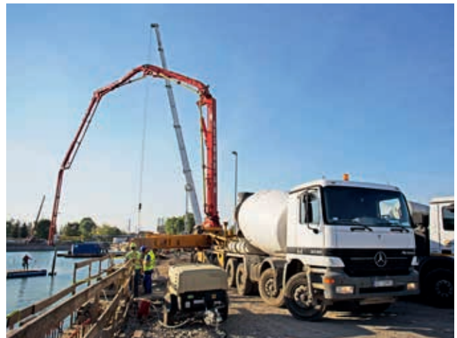
Prace przy wykonaniu korka betonowego w wykopie, fot. R. Jocher, Muzeum II Wojny Światowej w Gdańsku
