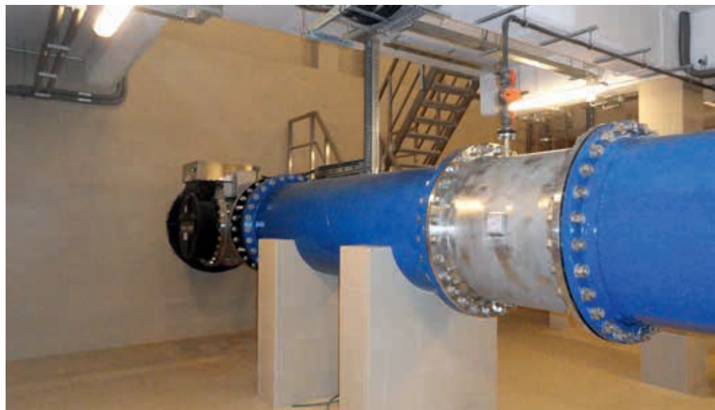
Wnętrze komory z fragmentem rurociągu wraz z zabudowanym promiennikiem UV i mieszaczem statycznym
