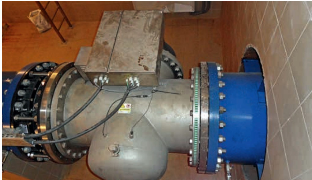
Promienniki UV zabudowane na rurociągu Raba II
