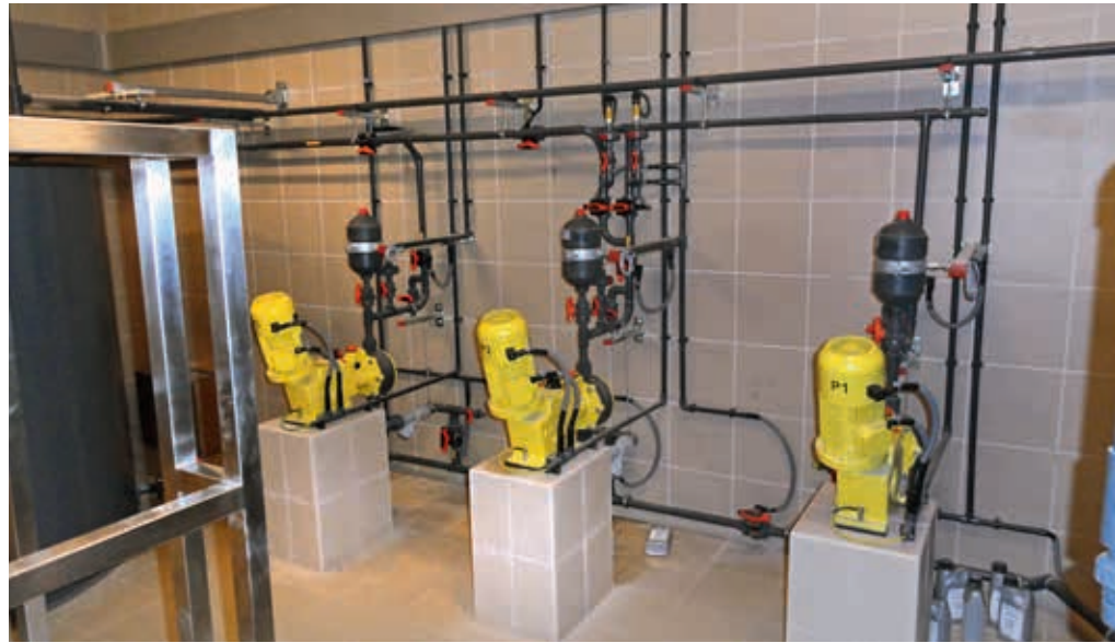
System dozowania roztworu podchlorynu sodu
