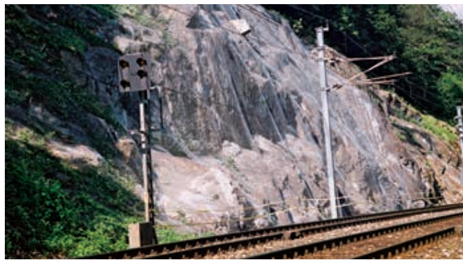
Geobrugg zapewnia skuteczną ochronę przed zagrożeniami naturalnymi: obrywami skalnymi, lawinami śnieżnymi oraz niestabilnymi skarpami. Linia kolejowa, Niemcy; fot. Geobrugg AG
