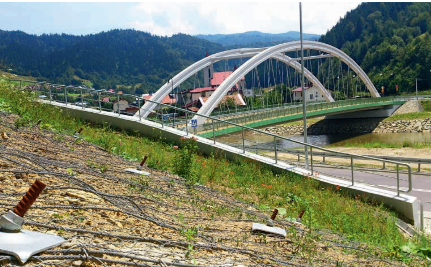
Zabezpieczenie zbocza przed osuwaniem za pomocą gwoździowania z siatką SteelGrid HR30 w Muszynie, fot. MACCAFERRI Polska Sp. z o.o.
