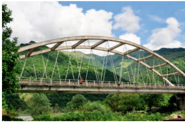
Ryc. 30. Łukowy most żelbetowy z jazdą dołem przez rzekę Khandoskhevi, fot. K. Flaga
