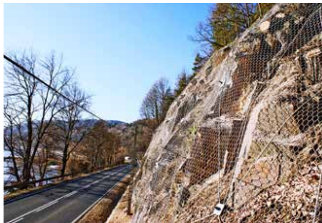
Kurtyna kotwiona zabezpieczająca pionowe zbocze skalne
