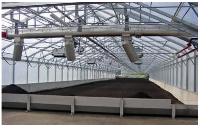
Wnętrze hali suszarniczej w technologii IST-Anlagenbau z automatycznym systemem podawania odwodnionych osadów do suszarni, fot. IST-Anlagenbau GmbH, EUROTECH Katarzyna Trojanowska
