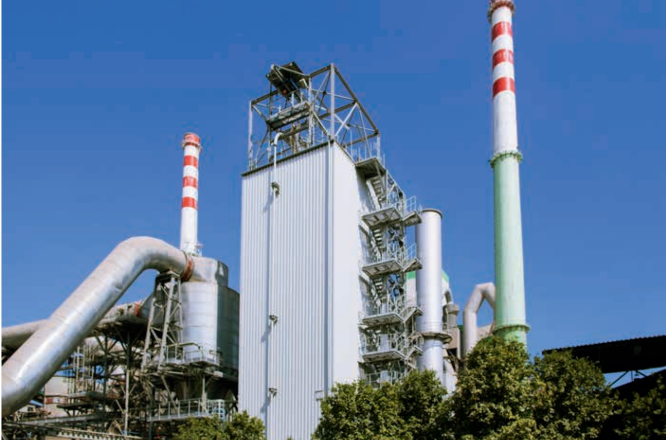
Instalacja dozowania suszonych osadów ściekowych w Góraździe Cement SA, fot. Góraździe Cement SA
