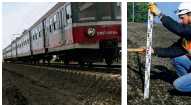
Ryc. 9. Korona nasypu 26 września 2014 r. (przemieszczenie ok. 60 cm)
