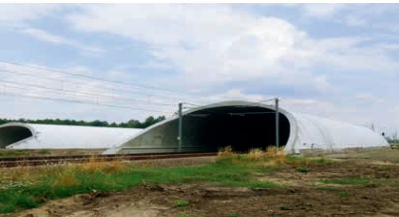
Ryc. 1. Kolejowy i drogowy tunel wiaduktu ekologicznego w technologii TechSpan® w Mosinie koło Poznania
