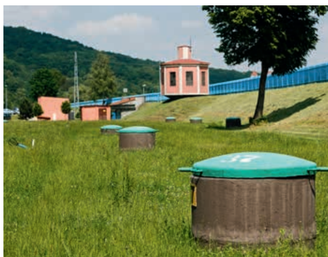
Studnie głębinowe ujmujące wodę do rurociągu lewarowego
