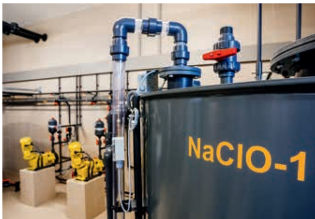
Dodatkowy system dezynfekcji w ZUW Raba polega na dawkowaniu do wody podchlorynu sodu
