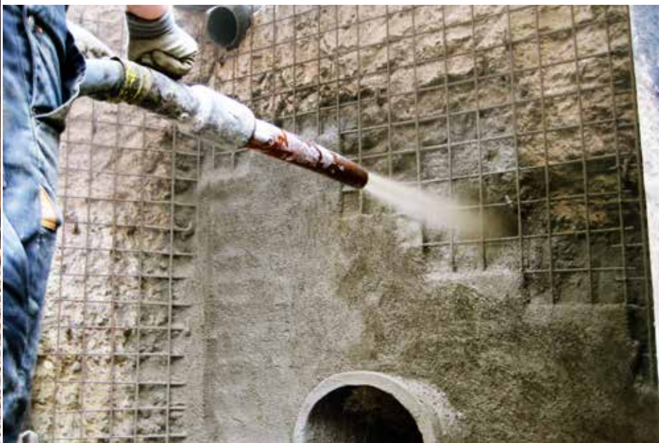
Nakładanie torkretu na powierzchnię ściany obiektu hydrotechnicznego – wykonawca POZIOM Gdańsk, fot. Michał Przedwojewski, quick-mix
