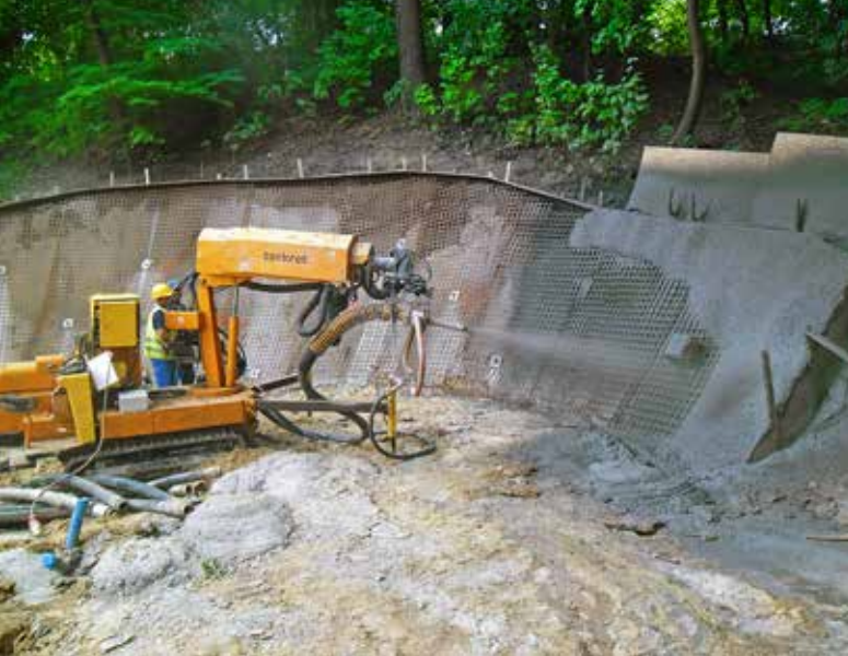
Umocnienie skarpy betonem natryskowym, fot. SPB Torkret Sp. z o.o. Sp. k.
