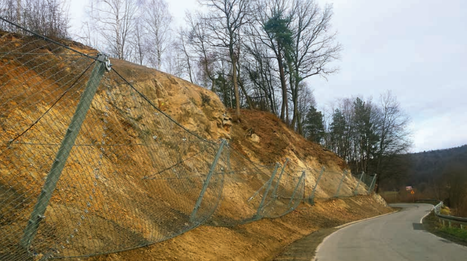
Bariera przeciwoślamiowa w Kamyku, fot. Zakład Inżynierijny Georem Sp. z o.o.
