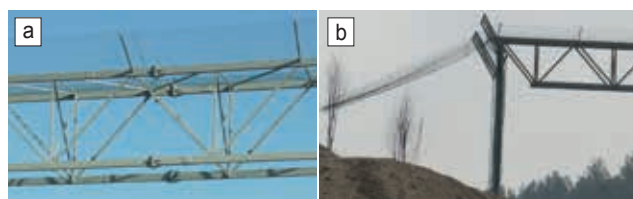
Ryc. 9. Elementy rozwiązań konstrukcyjnych bramownicy dla nietoperzy: a) szczegół głównego dźwigara kratowego i jego połączeń montażowych, b) widok podpory i schematu statycznego ramownicy
