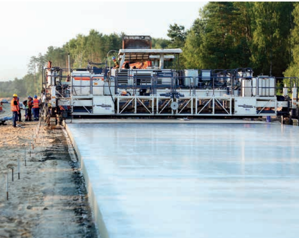
Budowa betonowego odcinka autostrady A1 Stryków – Tuszyn w najnowszej technologii nawierzchni betonowej z odkrytym kruszywem
