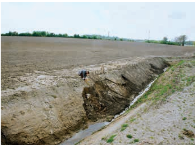
Regularne lokalne osuwiska skarpy w miejscach przerwanego i odsłoniętego drenu
