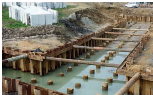
Ryc. 6. Przykładowy sposób wykonania fundamentowania w postaci palowania dla przepustu prefabrykowanego o przekroju skrzynkowym (na dalszym planie widoczne przygotowane prefabrykаты o przekroju dwudzielnym), fot. A. Wysokowski
