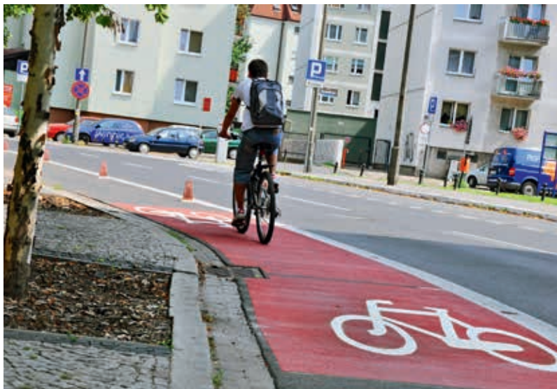
Bezpieczeństwo i sztuka wzornicza w jednym: kolorowa ścieżka rowerowa, wytyczona z wykorzystaniem żywicy chemoutwardzalnej Degaroute®, fot. Evonic Industries AG
