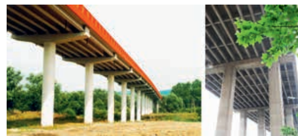
Ryc. 5. Estakada z belek prefabrykowanych w ciągu obwodnicy Kłodzka oraz estakada dojazdowa do mostu Lupu w Szanghaju w Chinach, fot. J. Biliszczuk
