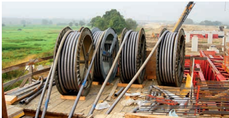
Ryc. 24. Kable prefabrykowane użyte na budowie obiektu WD22 na AOW
