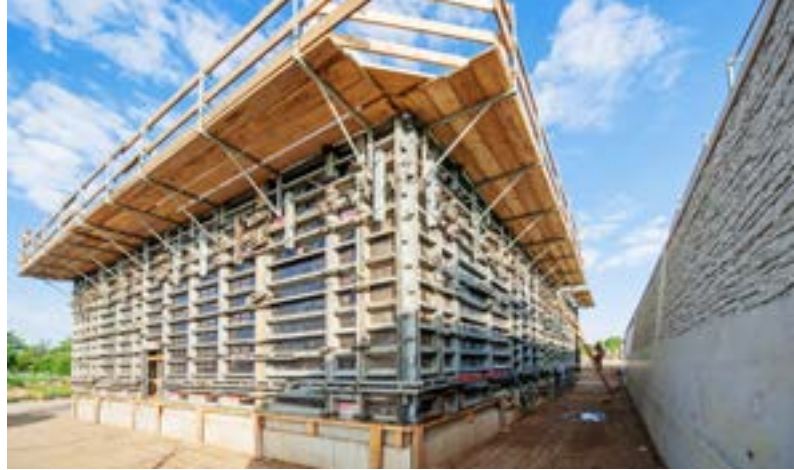
Wykonawca budynków pompowni na końcach wału przeciwpowodziowego na Łabie zdecydował się na zastosowanie sprawdzonego systemu szalowania NOEtop
