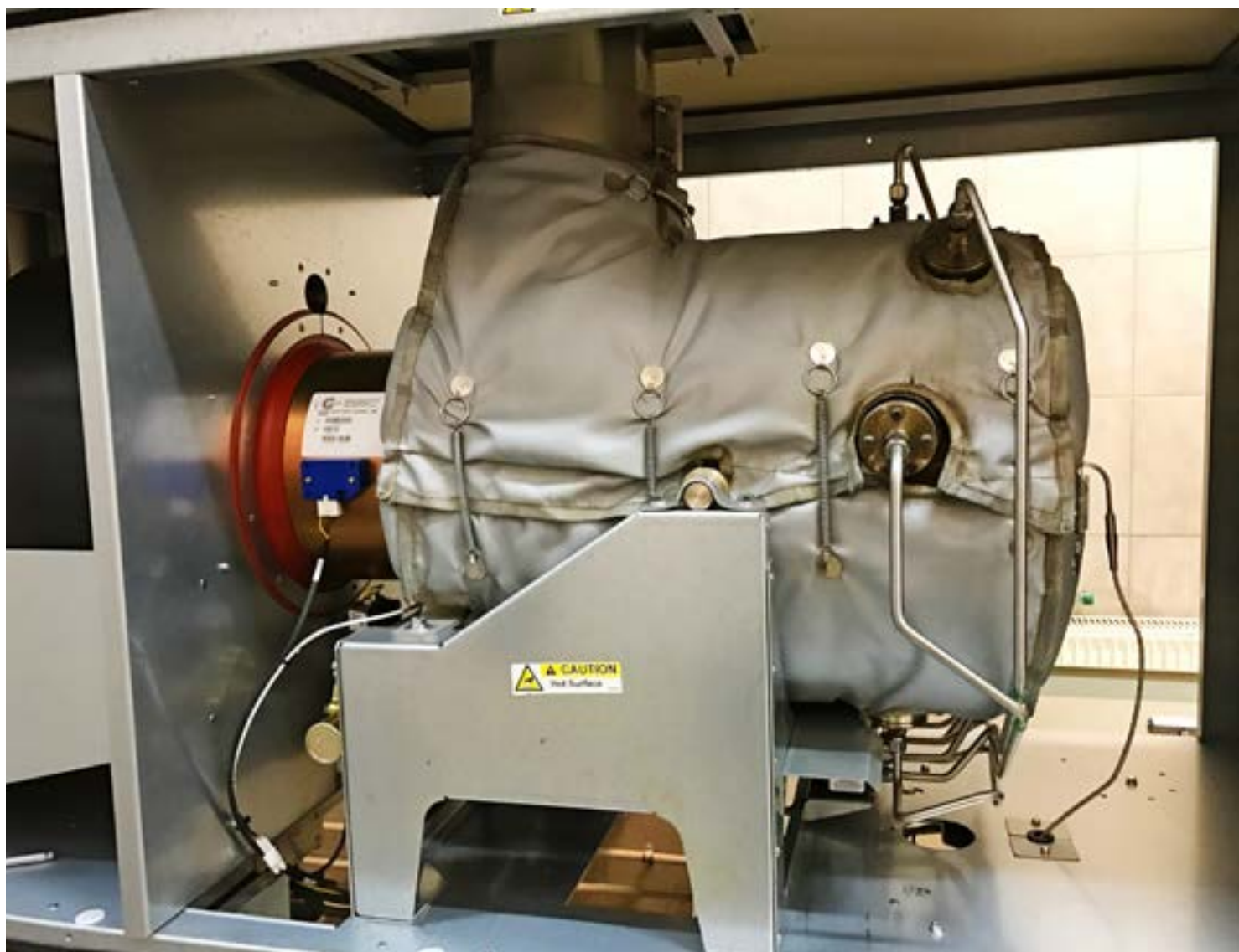
Turbina zasilana biogazem
