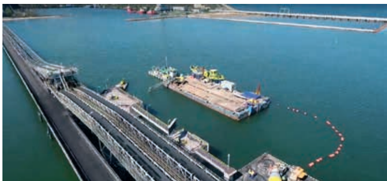
Ryc. 3. Miejsce kłamrowania narzutu kamiennego, fot. Łukasz Zieliński
