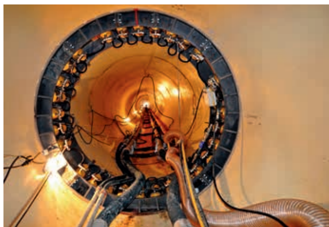
Kolektor Burakowski-Bis – kanał transportujący ścieki z funkcją magazynowania wody
