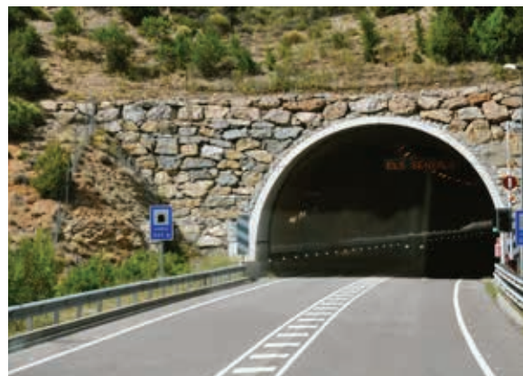
Wlot do tunelu Aubenc (333 m) na trasie od sanktuarium w Torreciudad do La Seu d'Urgell
