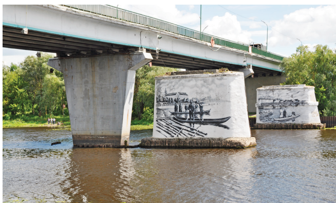
Betonowy, sprężony most belkowy przez Pinę w Pińsku. Na pierwszym planie planie filary starego mostu (obiekt nr 6)
