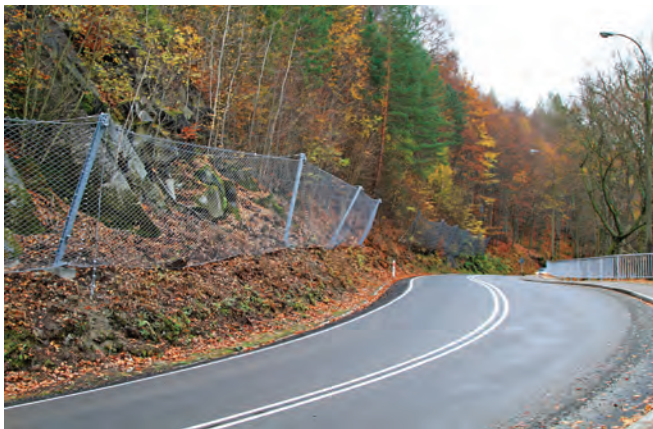
Droga wojewódzka nr 971 w Żęgiestowie, zamontowana bariera typu GBE-500-A
