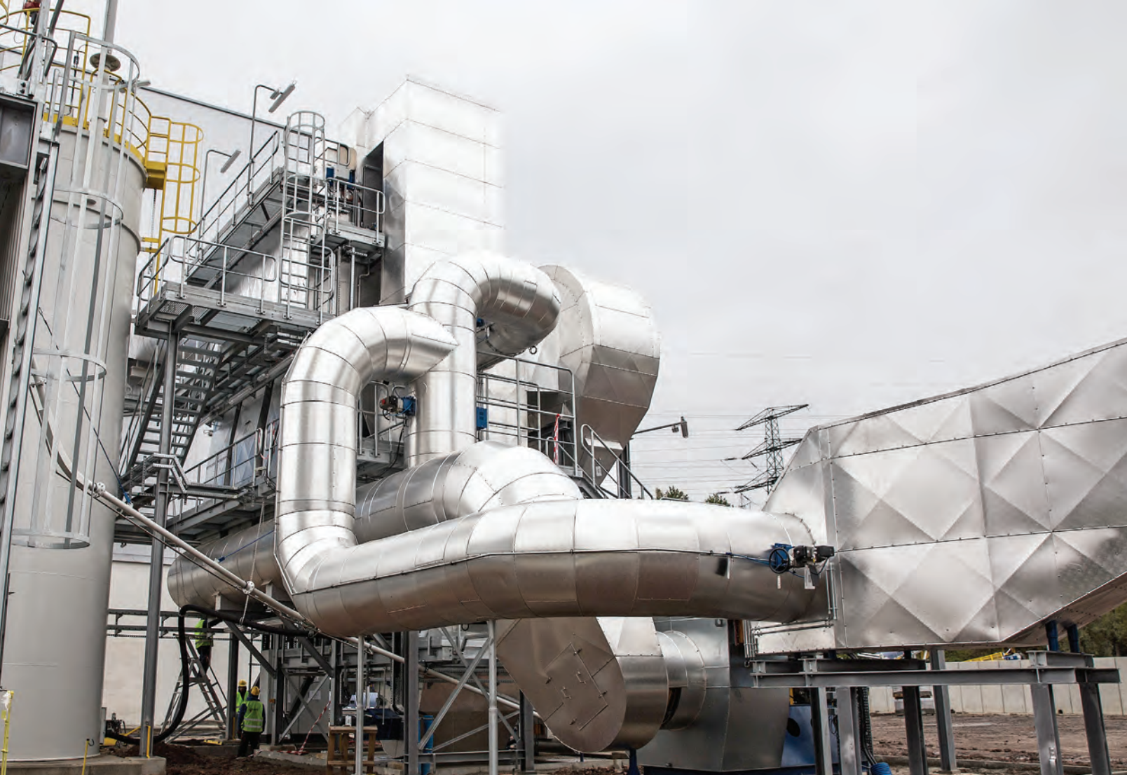
Ciepłownia Miechowice z kotłem WR-25 w Bytomiu
