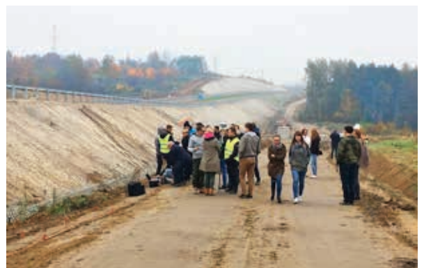
Wycieczka na budowę drogi wojewódzkiej na odcinku od skrzyżowania ul. Podkarpackiej z ul. 9 Dywizji Piechoty w Rzeszowie (DK19) do węzła Rzeszów Południe (S19)
