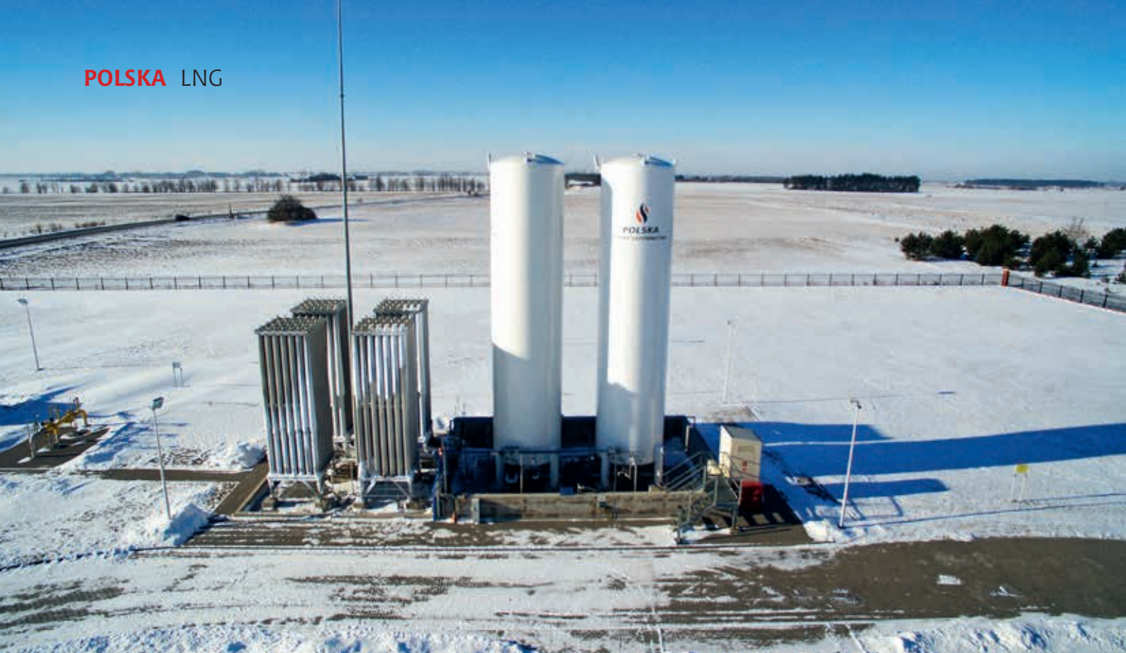
Stacja regazyfikacji LNG w miejscowości Zielone Kamedulskie zasila w błękitne paliwo pobliskie Suwałki. Stacją zarządza Polska Spółka Gazownictwa
