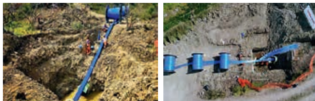
Ryc. 7a i 7b. Instalacja rękawa Primus Liner® podczas bezwykopowej rehabilitacji magistrali wodociągowej we Włoszech
