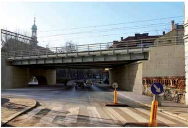
MODERNIZACJA LINII KOLEJOWEJ E38 NA ODCINKU KRAKÓW GŁÓWNY TOWAROWY – RUDZICE Wiadukt w km 0.400 linii nr 91 Kraków - Mydłko, ul. Kopernika, widok od wschodu Jednostka projektowa: BBF Sp. z o.o. (biuro) / BPN Mosty S.C. (zakład wykonawczy) Projektanci: Jerzy Świąk, Michał Piętarz
