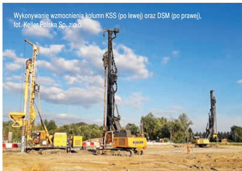
Wykonywanie pali CFA (na pierwszym planie) oraz kolumn DSM (w tle), fot. Keller Polska Sp. z o.o.
