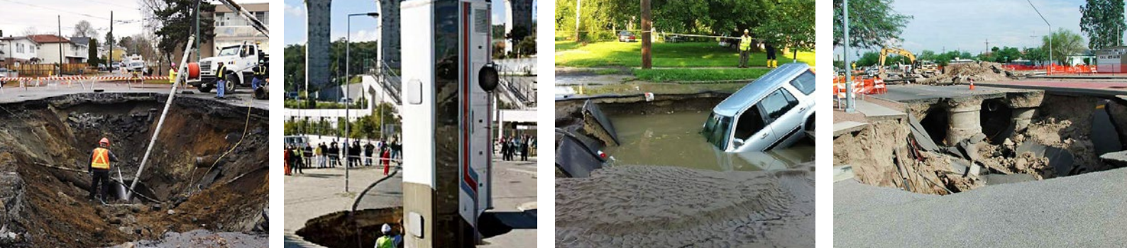
Ryc. 3. Zapadnięcie nawierzchni ulicznych spowodowane awariami przewodów kanalizacyjnych [12]
