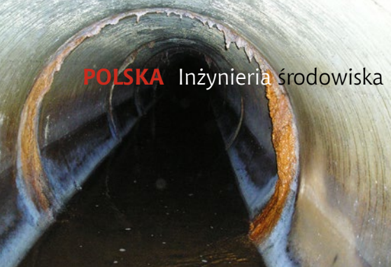
Ryc. 2. Narosty infiltracyjne na złączach rur [12]
