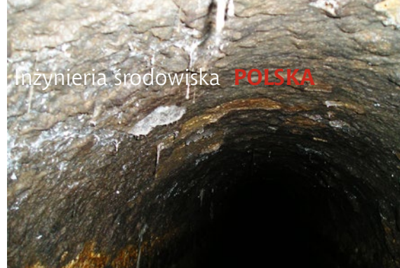
Ryc. 1. Korozja wewnętrznych ścian kanału [12]
