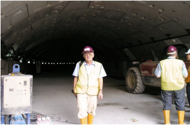
Ryc. 25. Widok górnej z trzech pótek przekroju poprzecznego w części środkowej kolektora deszczowego z opcją podziemnej autostrady w trakcie jego budowy z autorem tego artykułu, fot. ze zbiorów A. Kuliczkowskiego
