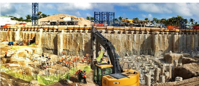
Widok na wykop w miejscu zrealizowanej przesłony poziomej i pionowej w kolumnach DSM
