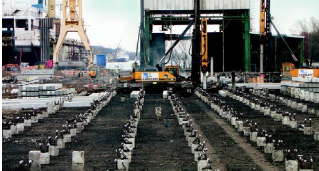
Posadowienie ciężkiej hali przemysłowej wraz z posadzką na żelbetowych palach w Szczecinie
