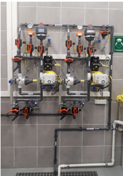
Układ dozujący podchloryn sodu w komorze KP-3
