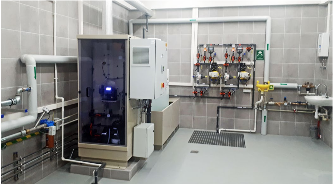
Instalacja wytwarzania podchlorynu sodu w komorze KP-3 w Sierczy
