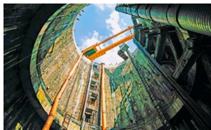
Ryc. 5. Wnętrze jednego z 50 szybów instalacyjnych [3]
